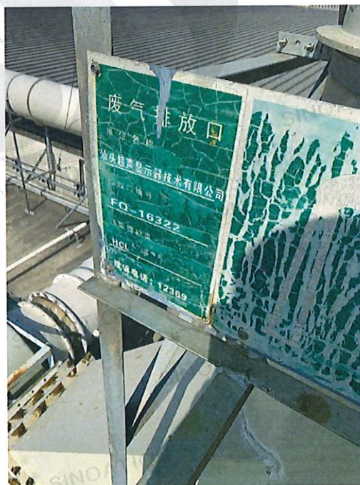
酸雾废气排放口 (FQ-16322) 排污铭牌
