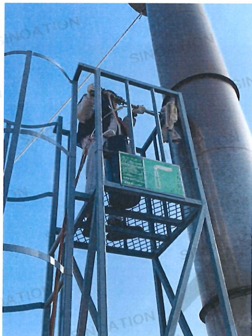
有机废气排放口 (FQ-16323)
