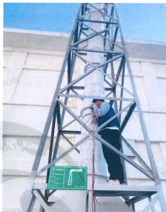
工艺废气排放口 (FQ-10831)
